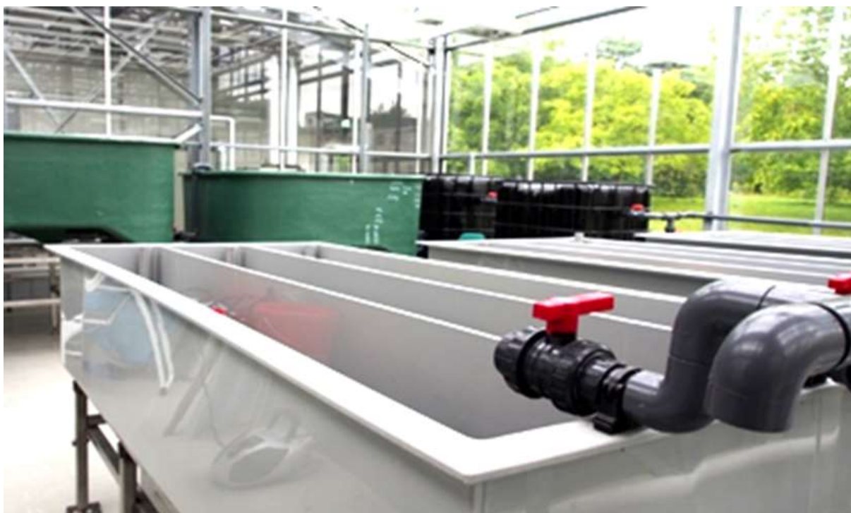
Rysunek 30. Fragment instalacji eksperymentalnej do hodowli w systemie akwaponicznym, znajdujący się na Uniwersytecie w Rostoku
